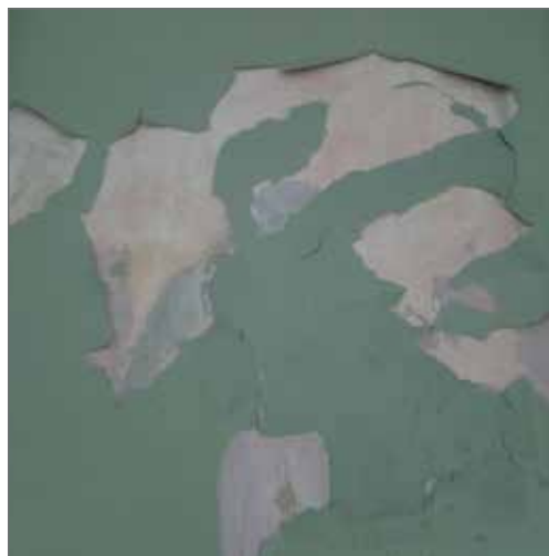
Илл.12. Отслаивающаяся краска в галерее — «Королевский гид».
