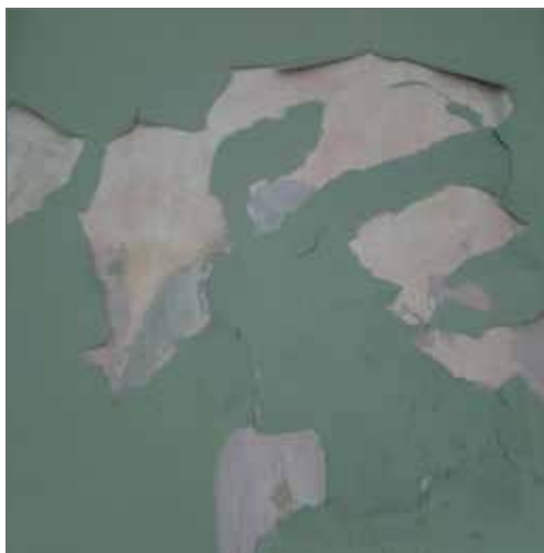
Илл.12. Отслаивающаяся краска в галерее — «Королевский гид».
